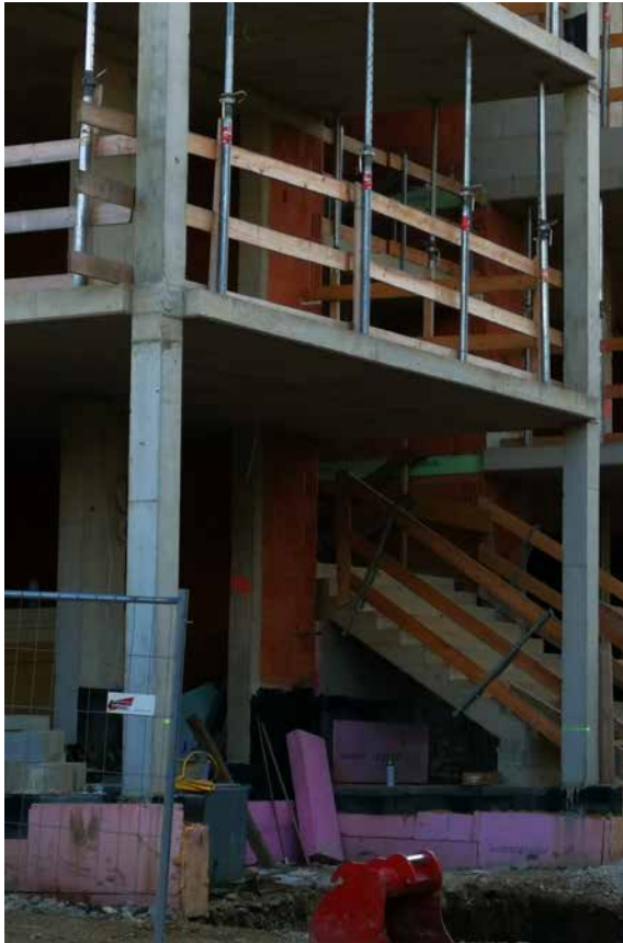
Beton bis fast an die Grundstücksgrenze! Der Grünraum existiert hauptsächlich beim Nachbarn!
